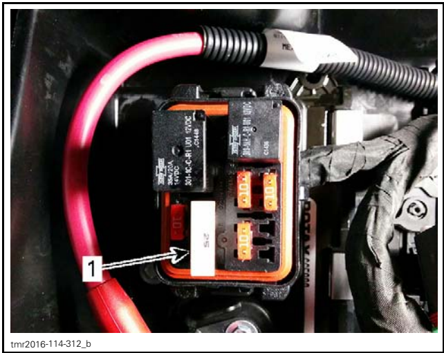
1. Cooling fan fuse
